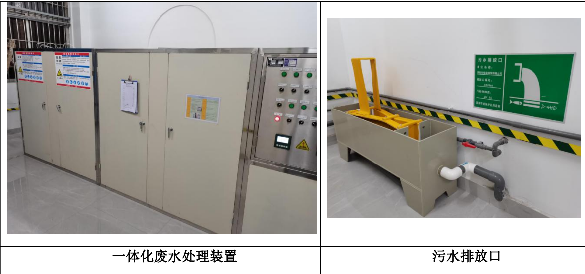
图3-1 自建污水处理系统
