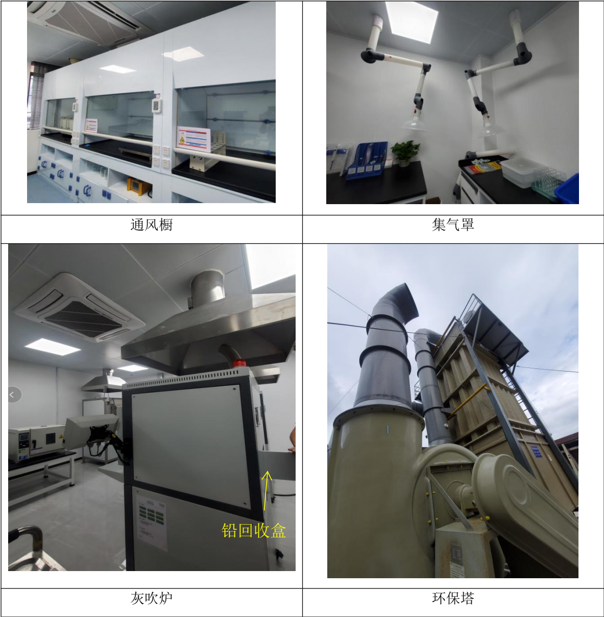
图 3-3 废气处理措施
